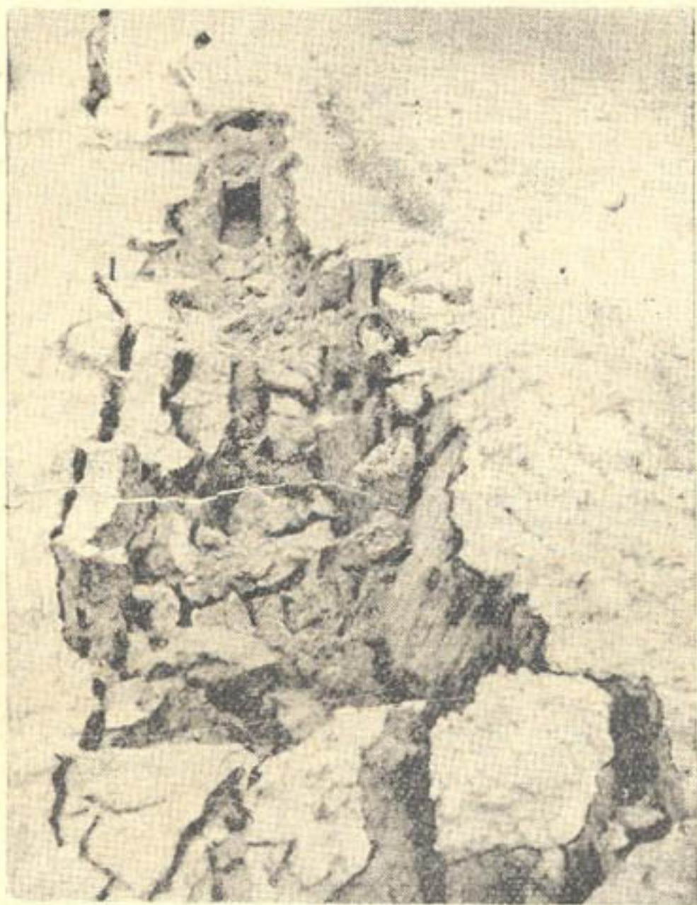
Рис. 1. Разрушение закрытой дрены поверхностной водой.
