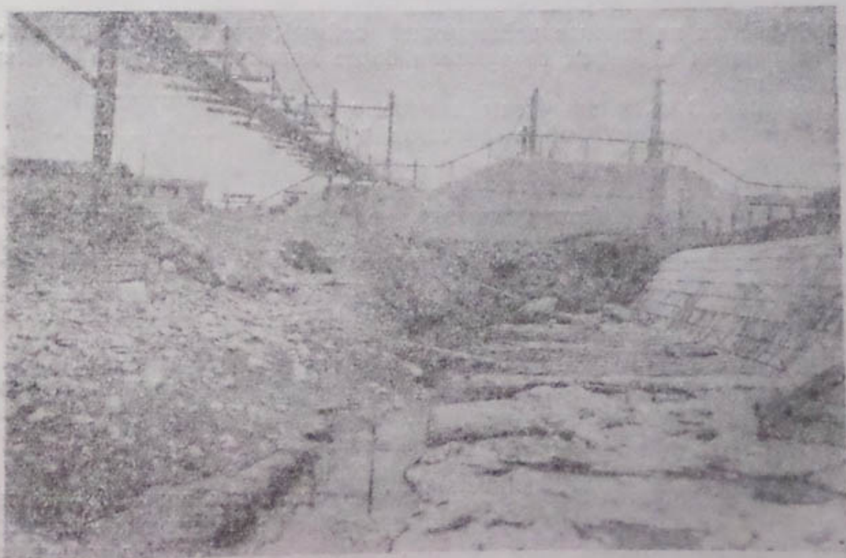
Рис. 18. Занесение нижнего бьефа у правой стороны водослива.
