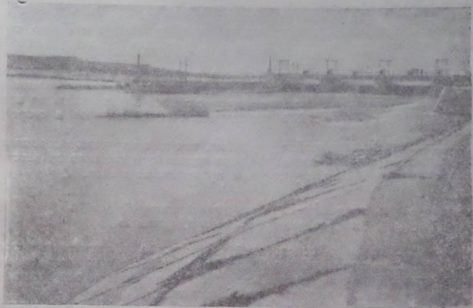
Рис. 21. Занесение правого кармана наносами после паводка 1950 г. (промывка в период спада паводка не дала результата ввиду высоких отметок дна в нижнем бьефе промывных шлюзов).
