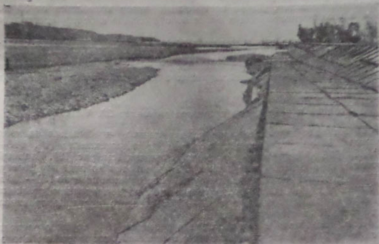
Рис. 22. Разрушение правой струенаправляющей дамбы на расстоянии 400 м от сооружения.
