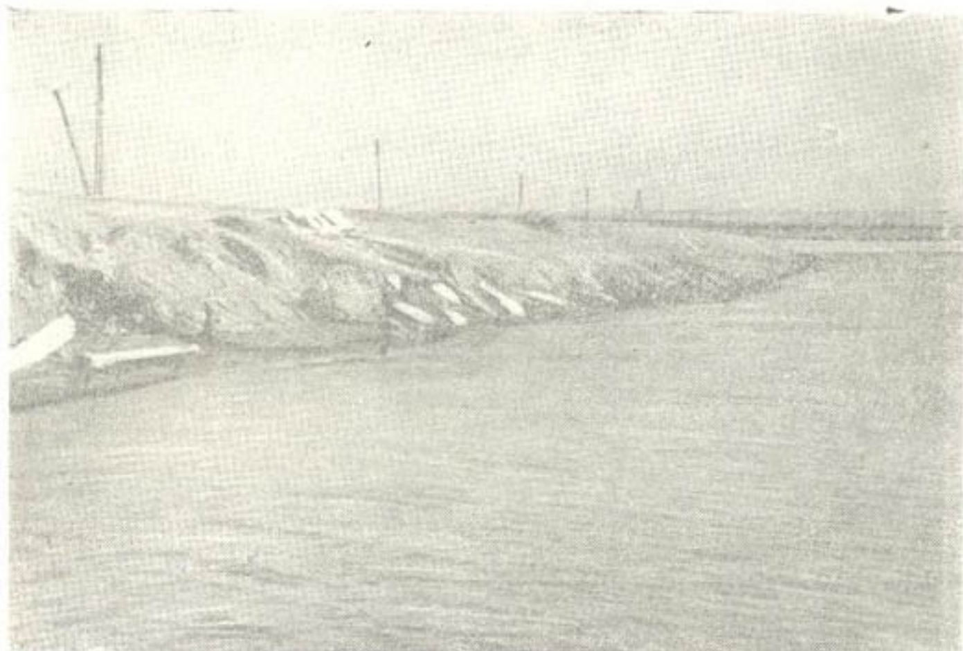
Рис. 5. Кайраккумское водохранилище; вид разрушенного крепления поселковой дамбы.
