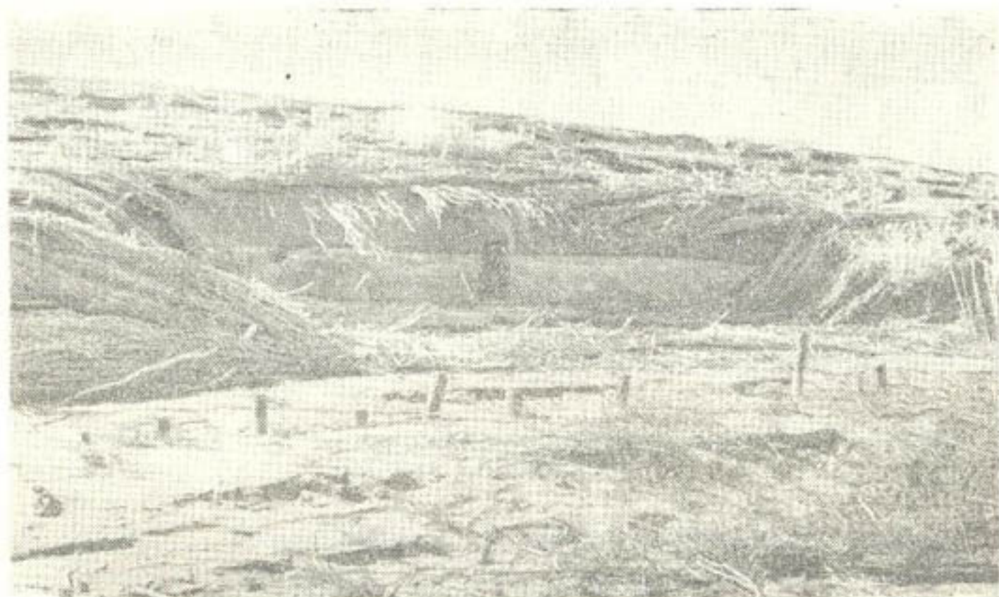
Рис. 8. Тедженское водохранилище; разрушенное фашинное крепление левой дамбы.
